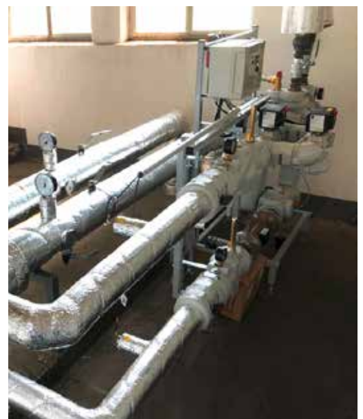
Station für die Fernwärmeübergabe
