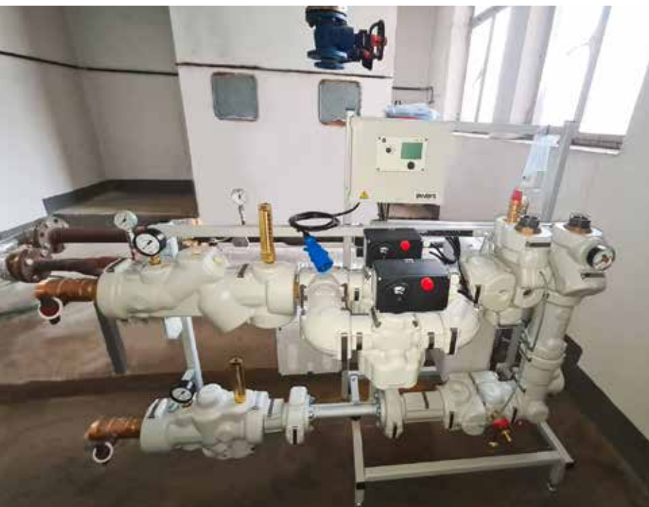
Station für die Fernwärmeübergabe
