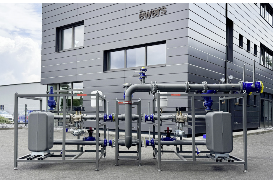
Die ewers Lösung: 1350 kW Station für die Fernwärmeübergabe
