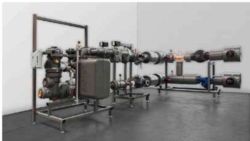
es Individuelle Wärmeübergabestation | Individual heat transfer station
