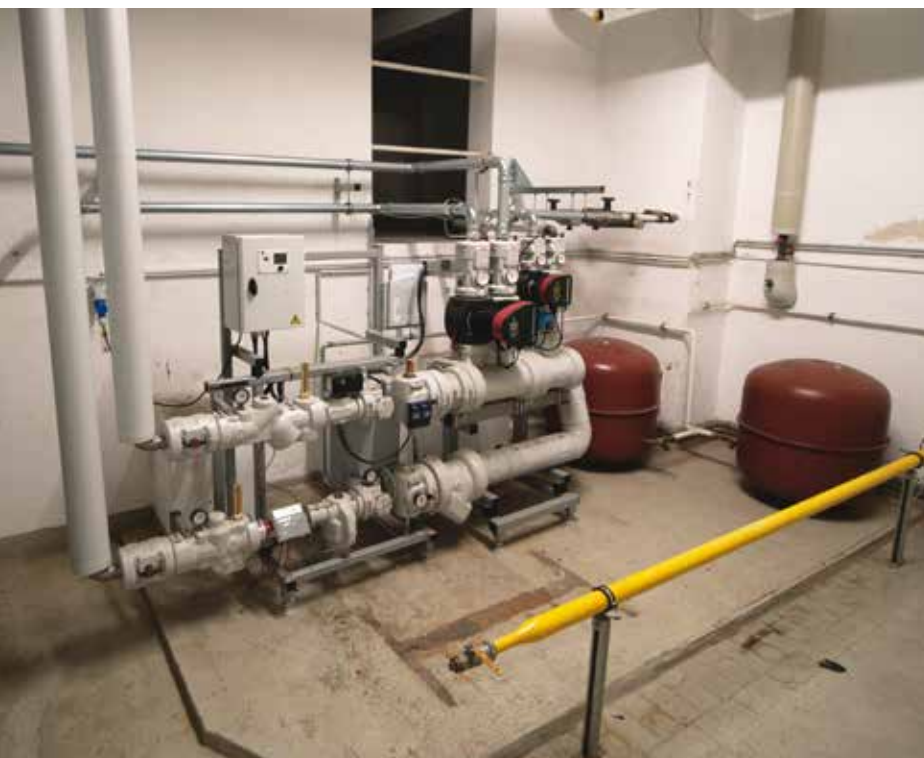
Die ewers Anlage im alten Kohlekeller des Gebäudes
