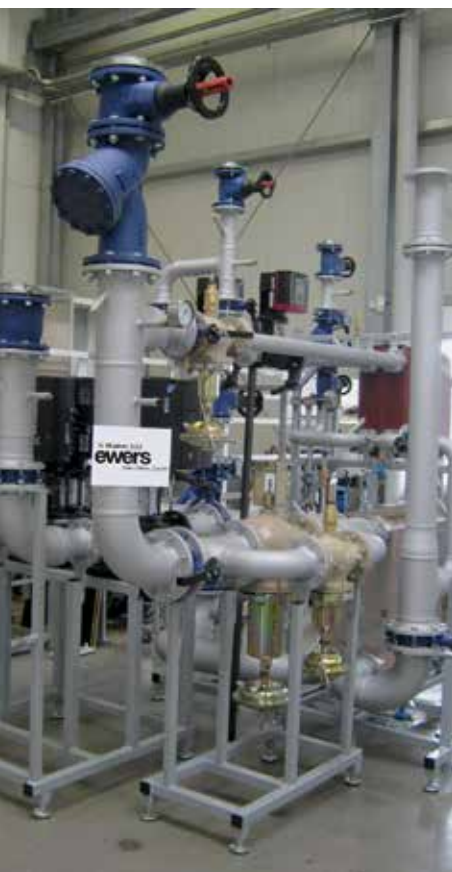
Die ewers Anlage — Modularer Aufbau 3 MW bestehend aus Volllastmodul 2,5 MW und Teillastmodul 0,5 MW
