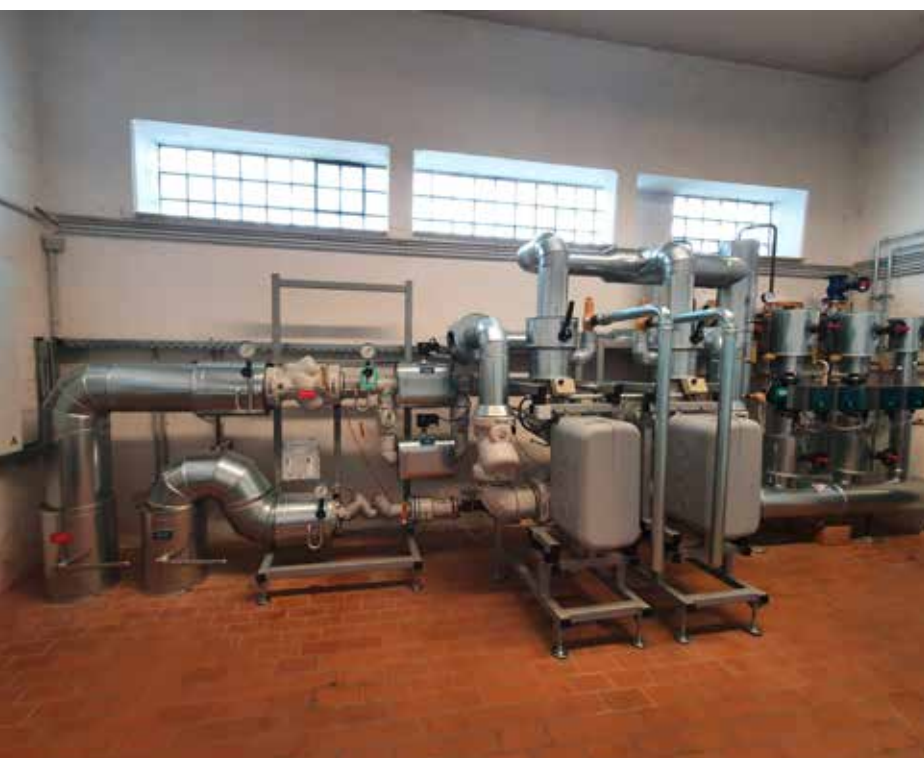
Station für die Fernwärmeübergabe
